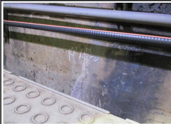
균열 및 백태(폭 0.3mm미만) (S14-외선 내측면)
