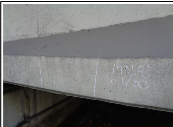
균열(폭 0.3mm미만) (S01-내선 G1)
