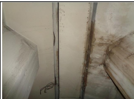
배수관 지지대 탈락 (S01)
