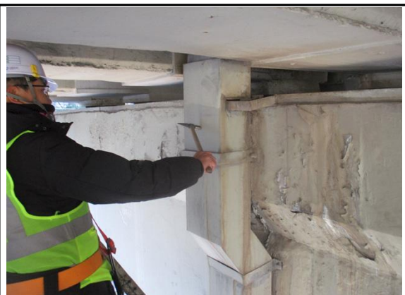
점검망치를 이용한 배수관 막힘 여부 조사
