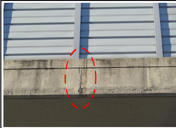
균열 및 백태(폭 0.3mm이상) (S13-내선 외측면)
